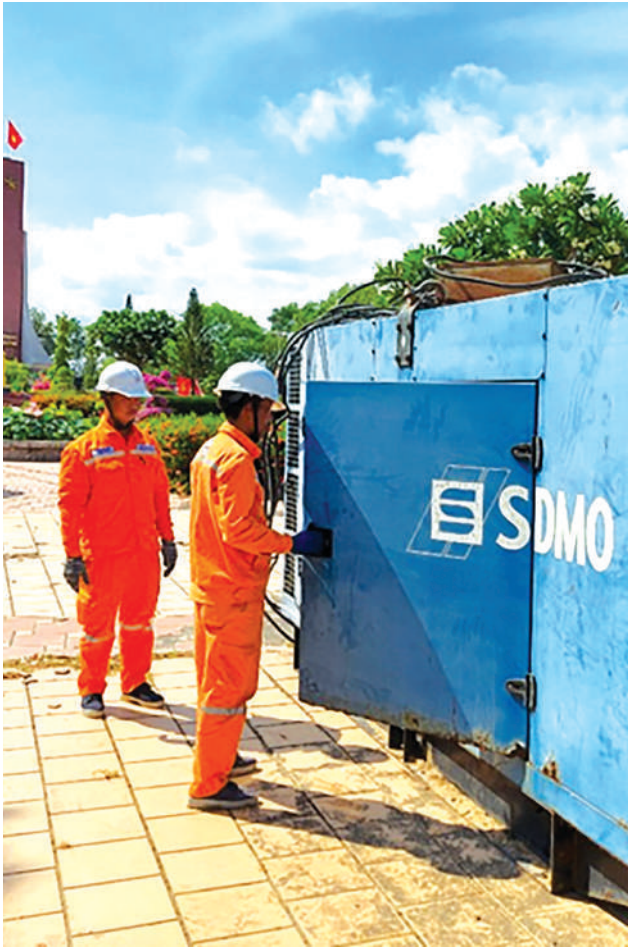
Chuẩn bị nguồn phát dự phòng đảm bảo cấp điện cho các điểm thi
