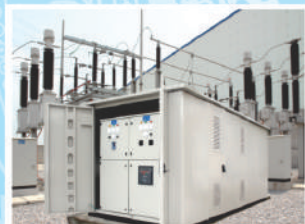
Trạm Kios Kiosk substation
