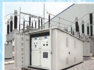
Trạm Kios Kiosk substation
