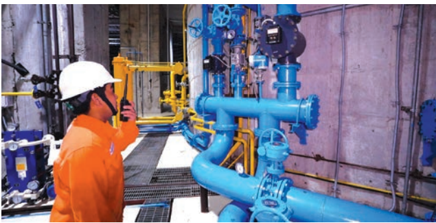
Trong thời điểm nắng nóng cao điểm như hiện nay, các nhà máy thuộc Công ty Thủy điện Buôn Kuốp đã tăng cường kiểm tra, kịp thời phát hiện sự cố, bất thường thiết bị, đảm bảo tổ máy sẵn sàng vận hành an toàn, hiệu quả
