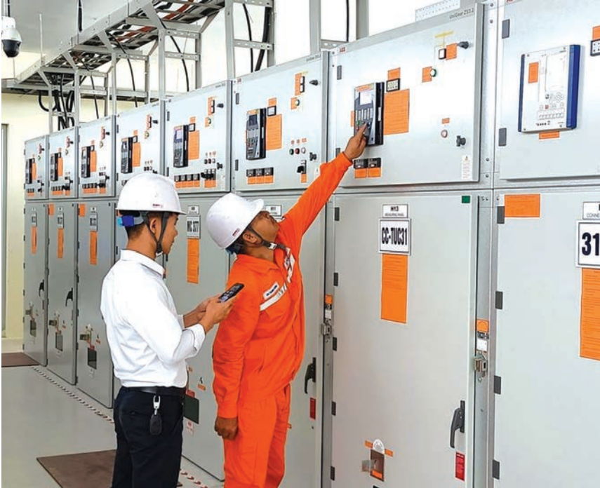
PC Hải Dương kiểm tra hệ thống rơ le kỹ thuật số đường dây 22kV
