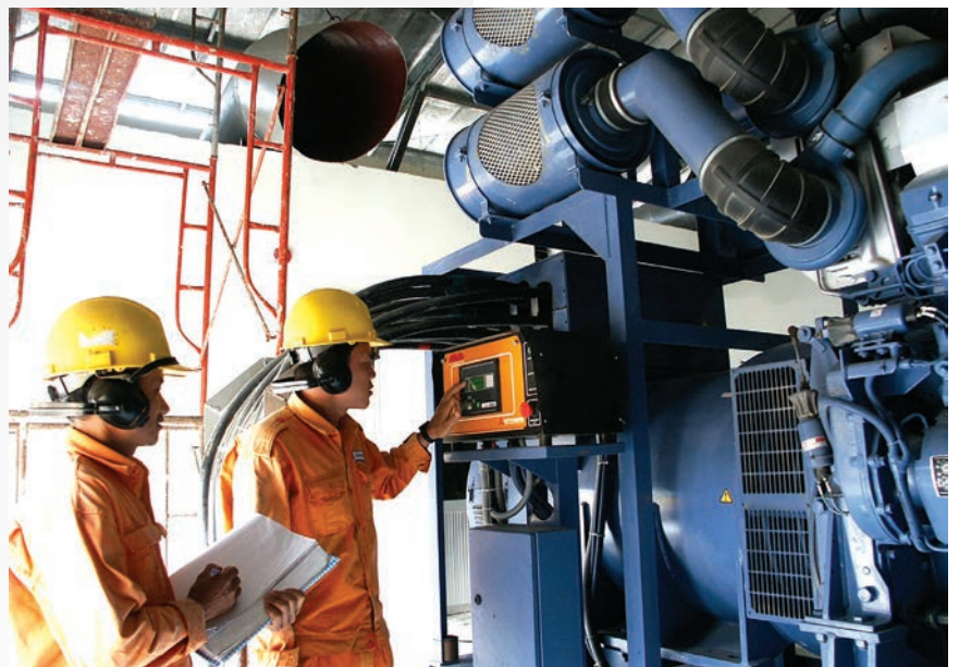
Vận hành các tổ máy diesel tại Phú Quốc vừa được khánh thành vào tháng 7/2004
