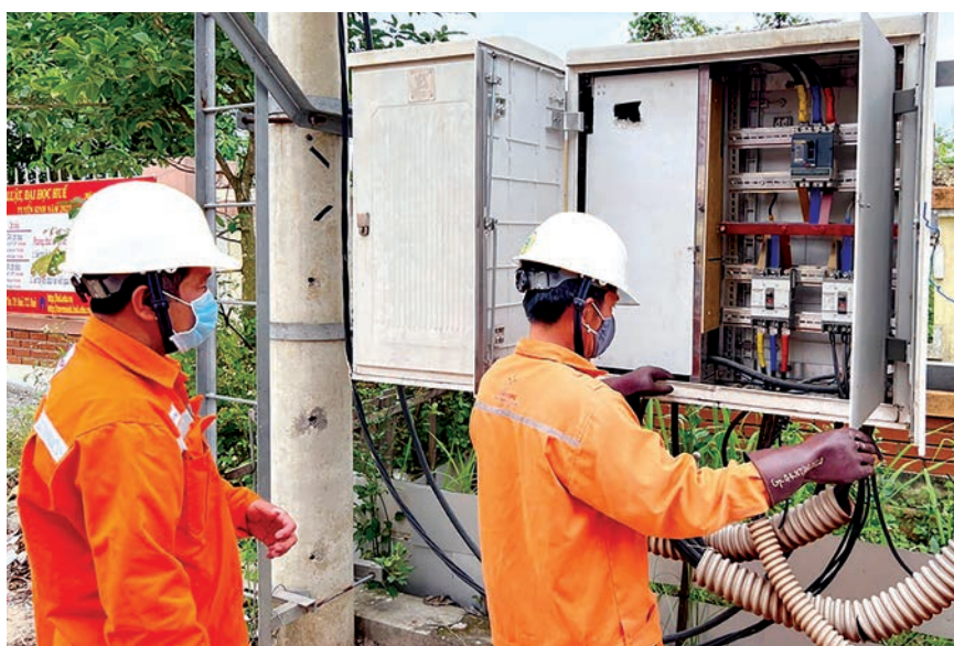
Các đơn vị Điện lực tăng cường kiểm tra, đảm bảo vận hành lưới điện an toàn, liên tục
