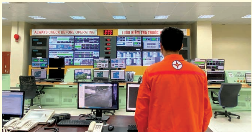
Khu vực Phòng điều khiển trung tâm tại Nhà máy Nhiệt điện Mông Dương
