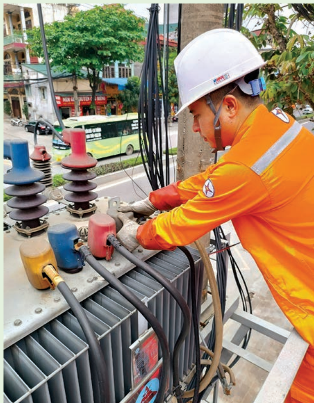
Các đơn vị Điện lực thuộc PC Ninh Bình luôn thực hiện kiểm tra TBA định kỳ nhằm hạn chế những sự cố xảy ra
