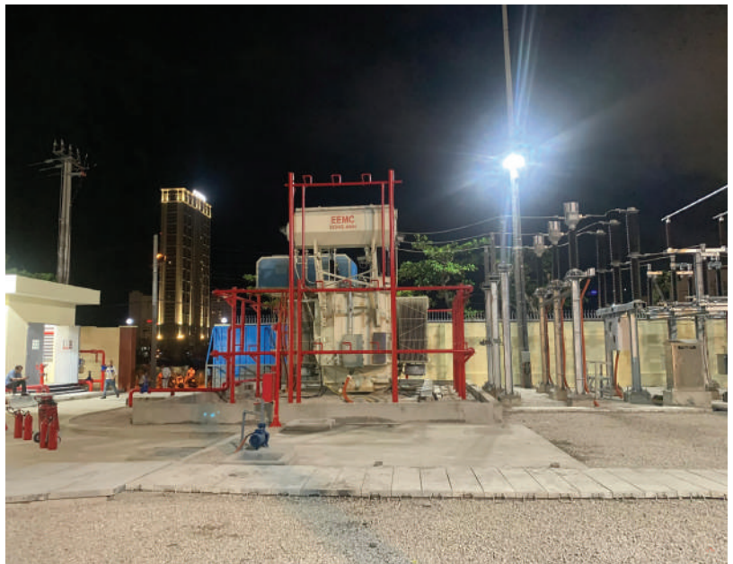
Trạm biến áp 10kV Cảng Quy Nhơn và các hạng mục đồng bộ của dự án được đóng điện an toàn
