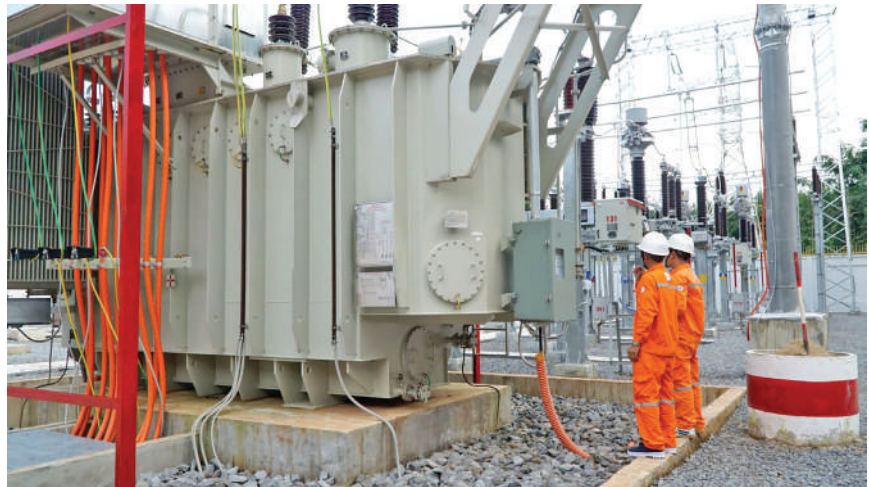
Trạm biến áp 110 kV Suối Tre, tỉnh Đồng Nai
