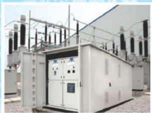
Trạm Kios Kiosk substation
