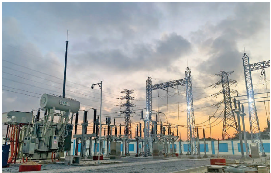
Trạm biến áp 110kV Ascendas - Bình Dương
