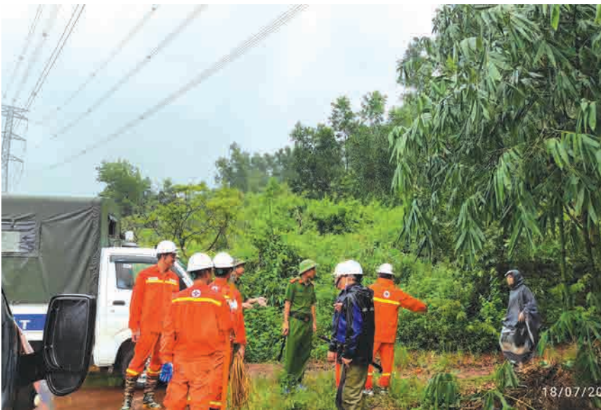
Truyền tải điện Đông Bắc 1 phối hợp với Chính quyền và Công an địa phương xử lý cây cao khu vực hành lang đường dây, nguy cơ phóng điện gây sự cố đường dây 500kV Quảng Ninh - Hiệp Hoà
